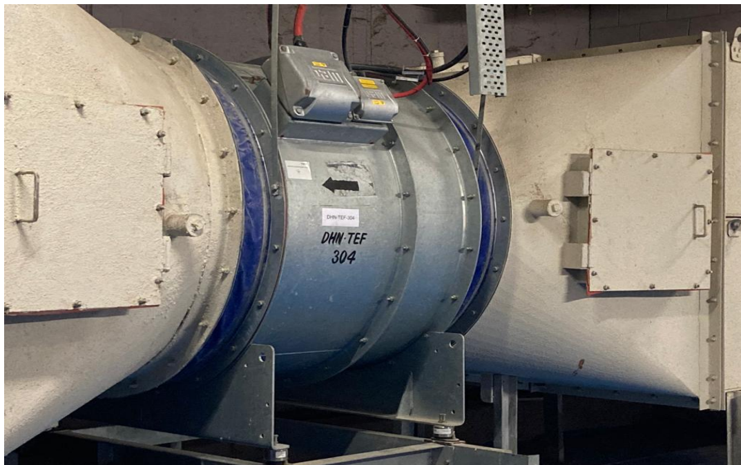
Trackway Exhaust Fan
