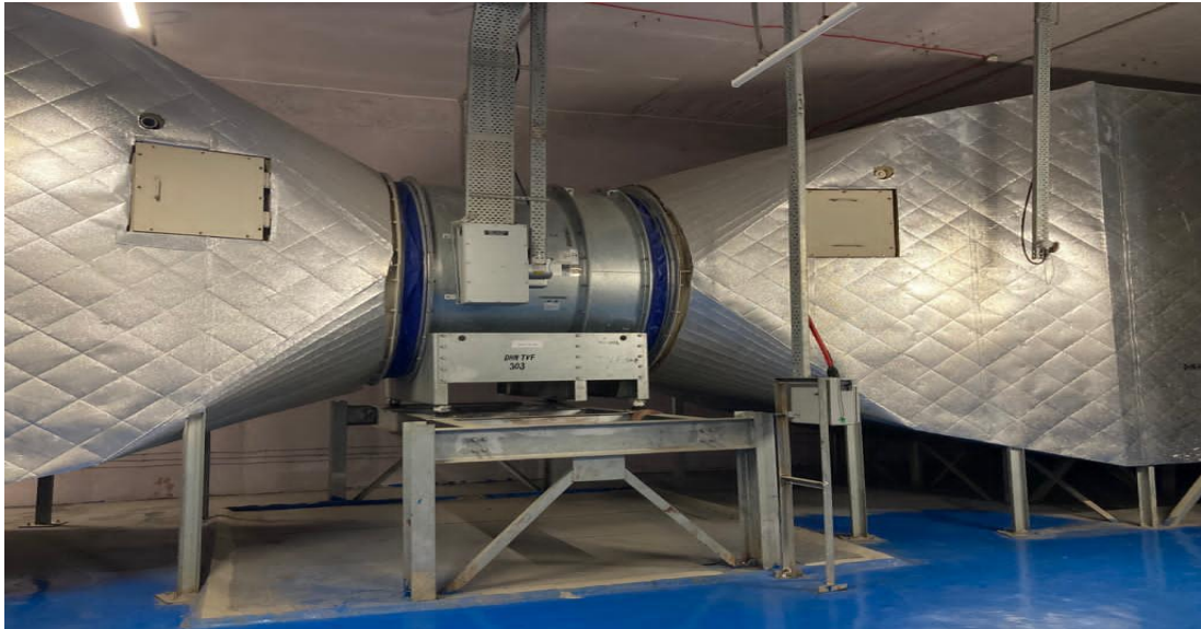
Tunnel Ventilation Fan
